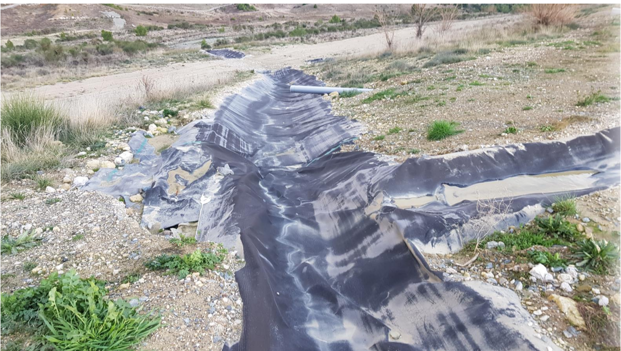
Point d'observation 12 : Erosion des matériaux en amont et au niveau de l'ancrage du DEDG
