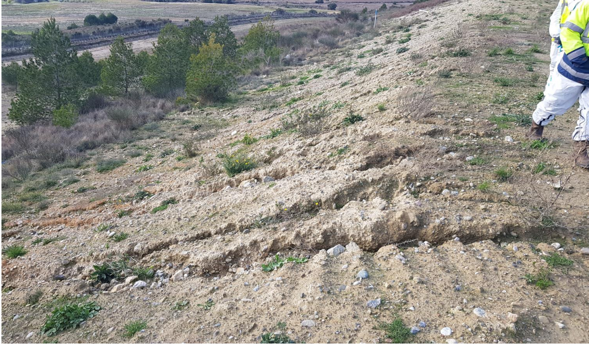
Zone 7 : Vue d'ensemble depuis le Sud-Est de la zone 7 avec traces d'érosion
