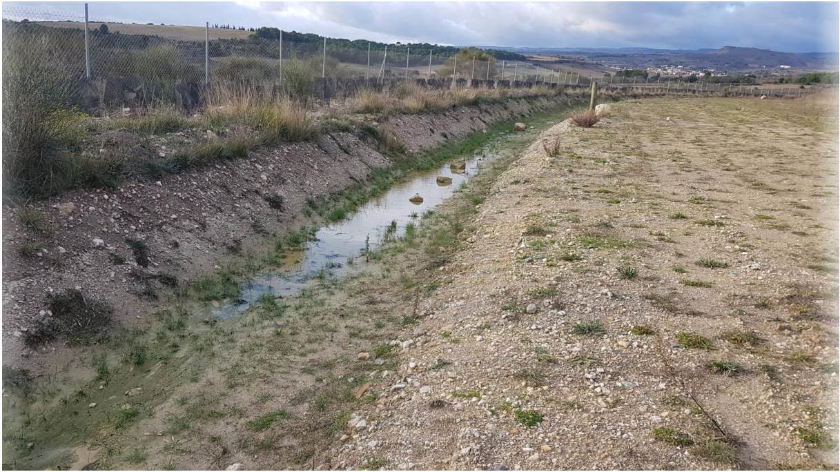
Point d'observation 8 vers le Nord /Ouest : fossé reprofilé et recalibré avec zones de stagnations d'eau résiduelles
