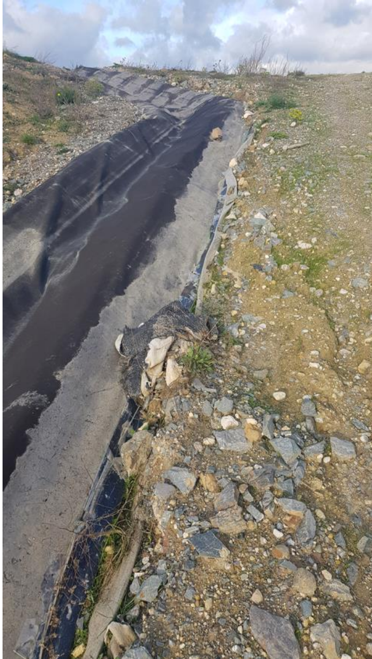
Point d'observation 4 (2022) : traces d'érosion à proximité du fossé
