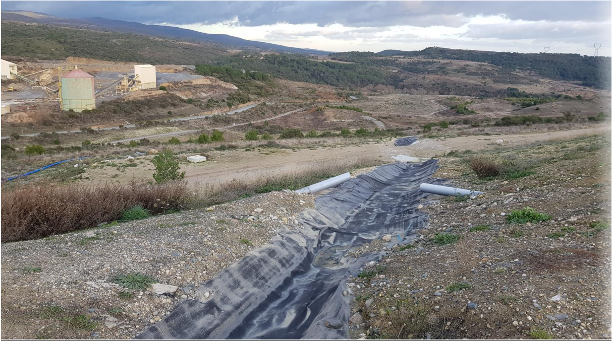
Point d'observation 11 : Erosion des matériaux en amont et au niveau de l'ancrage du DEDG
