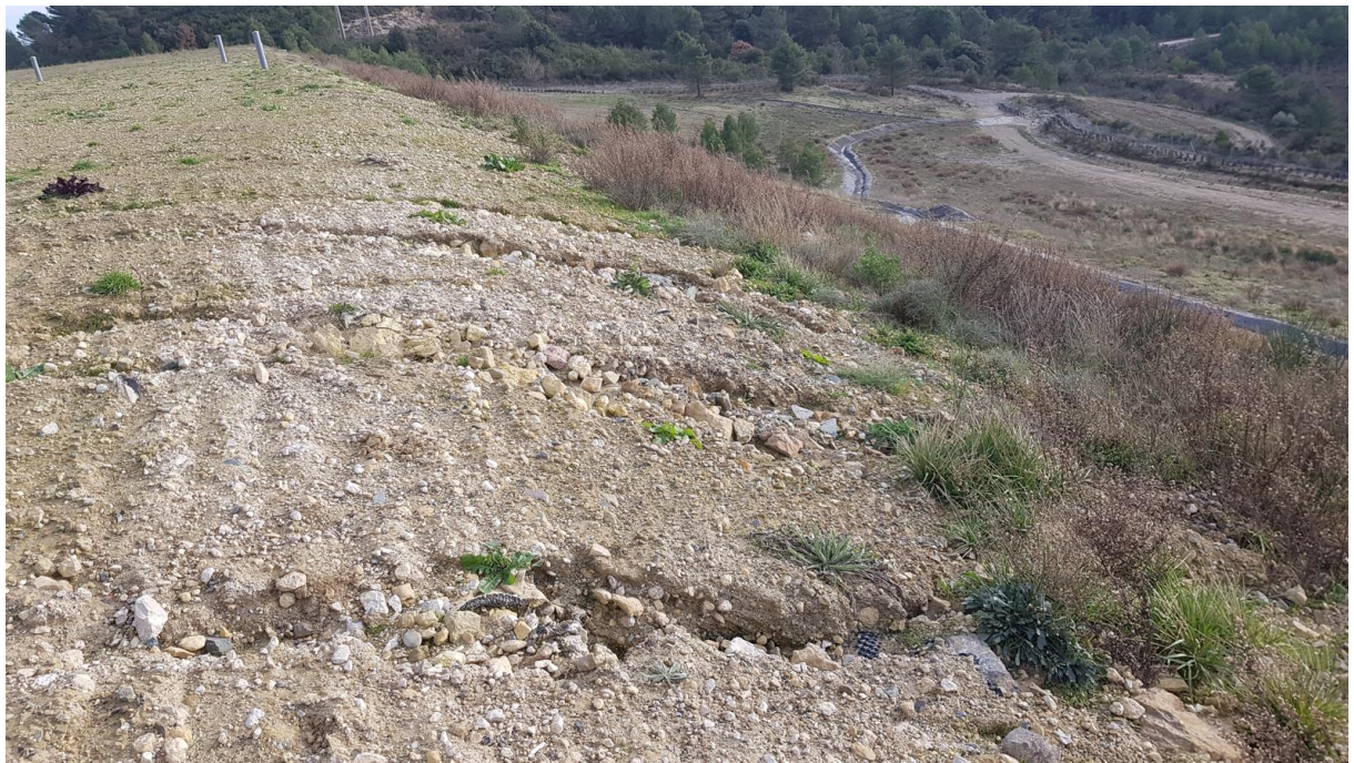
Zone 7.2 : Traces de ravinement sur talus et mise à jour DEDG
