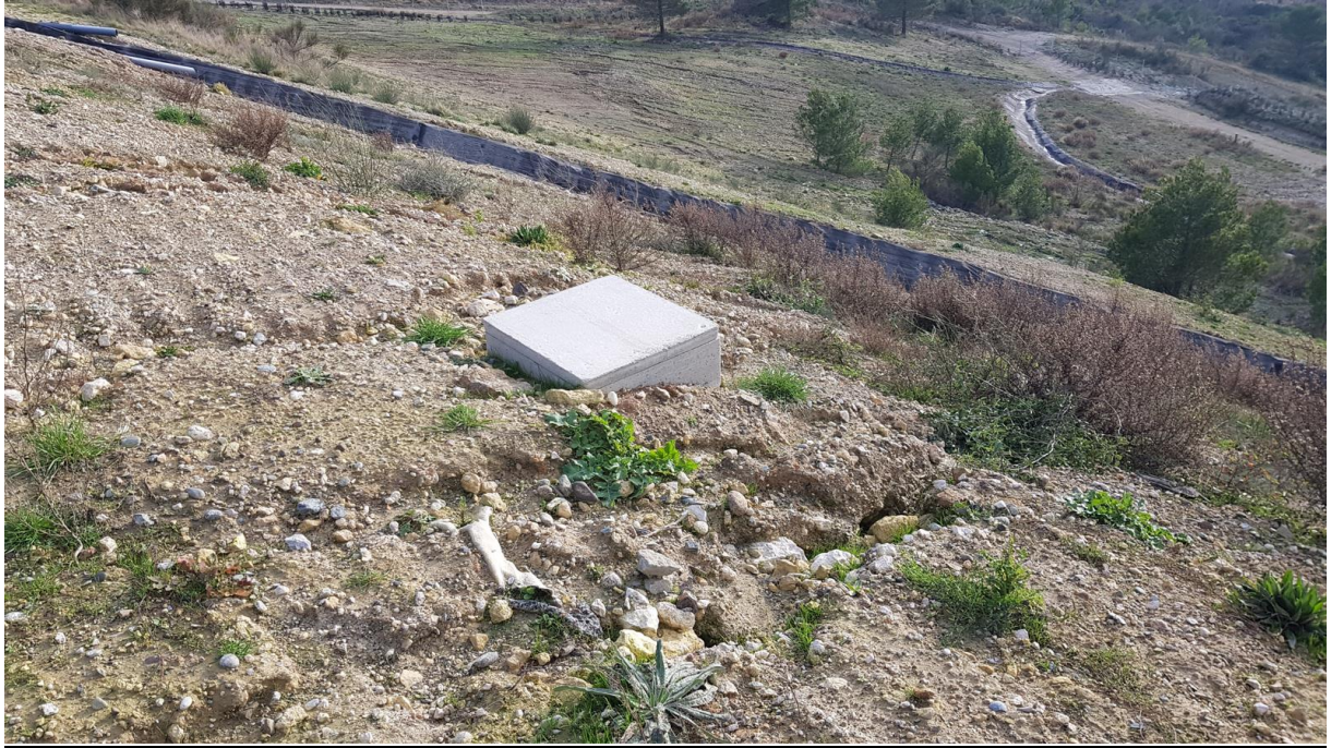
Zone 7.1 : Traces de ravinement sur talus
